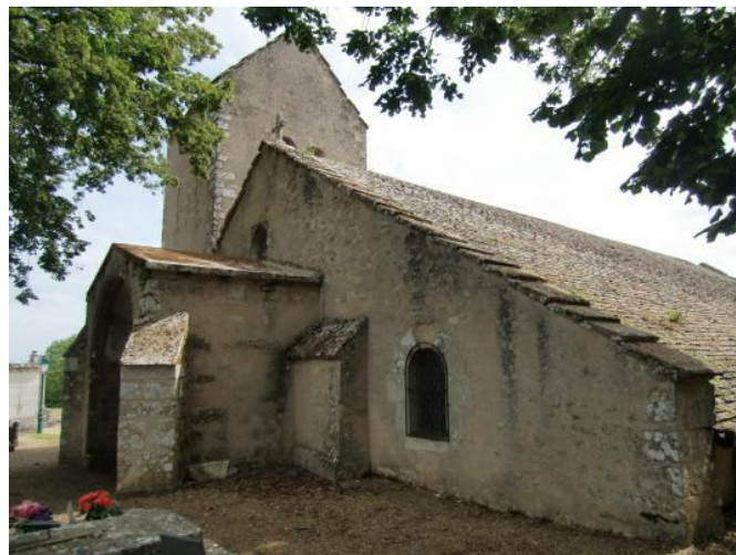
L'église de METZ LE COMTE a été remaniée au XIII ème siècle. Le clocher, modifié en 1770, abrite une cloche datant de 1500. Une particularité : l'écoulement des eaux pluviales se fait par des gouttières en bois reposant sur des contreforts enterrés.
